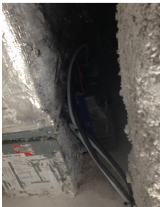
Un clapet incendie qui n'a pas le droit de tomber en panne car il est inaccessible.
